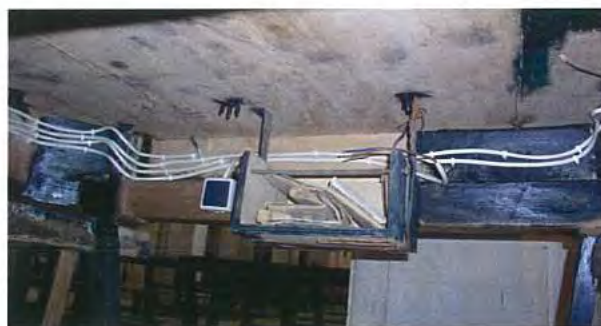
L'auréole munie de diodes est alimentée par une batterie installée sous le plateau dans le caisson conçu par les confrères à cet effet. Un fil électrique doté d'un interrupteur remonte le long de l'arbre.
