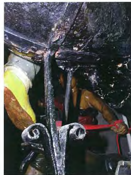
Soutien métallique, peut-être original, mais la barre filetée, à droite, est un ajout récent
