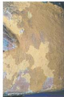
Fig. 76 Détail dégradation de la couche jaune.
