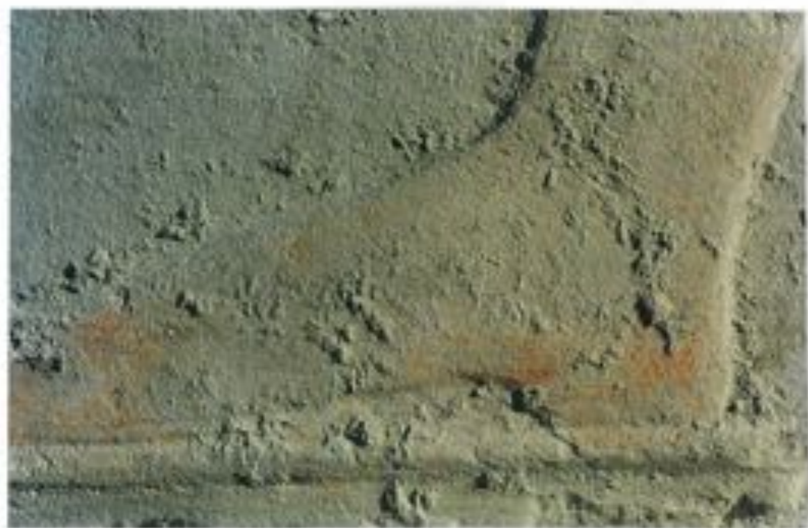
Photo 8 - détail montrant le dépôt de poussière, de terre séchée et les concrétions
