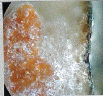
ENDUIT Grossissement x100
