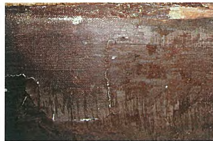
17. Détail de la bordure supérieure : incrustation inesthétique
