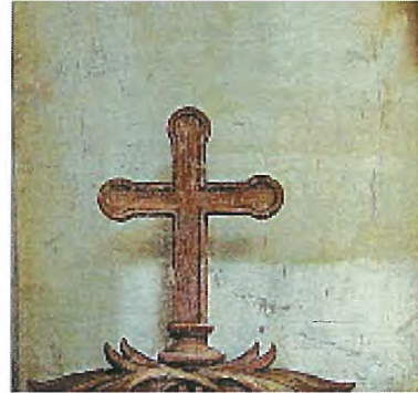
22. Le témoin de dévernissage met en exergue le jaunissement du vernis sur la colonne droite du jubé
