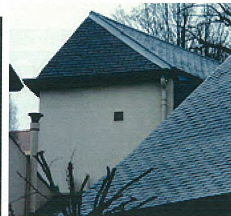
Vue latérale de l'extension du chœur et de sa jonction avec le chœur
