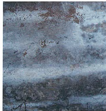
Vue du mur du fond dégradé
