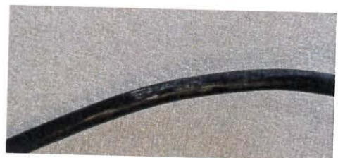
Le câble d'alimentation, CT©
