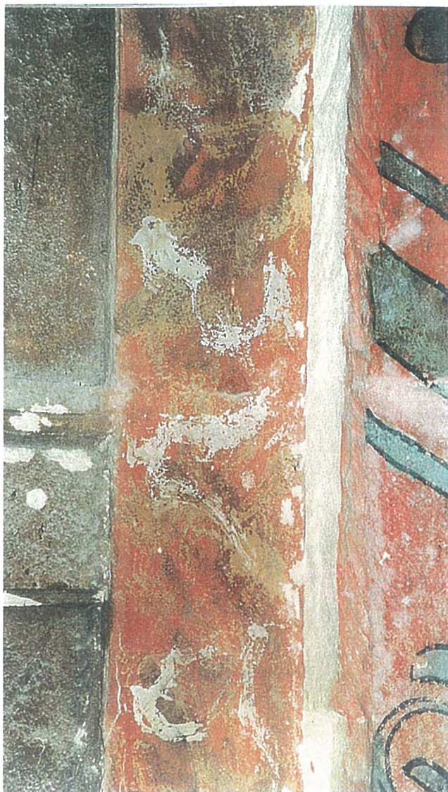
photo 68 : mur Nord, pilastre et faux-marbre
