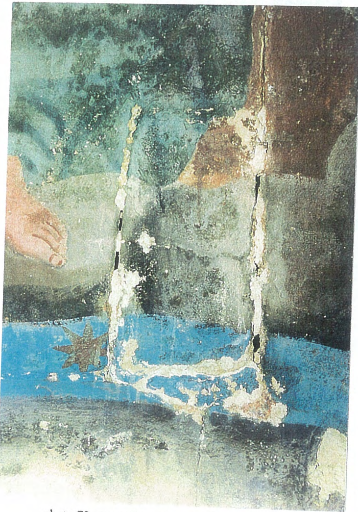
photo 79 : perte de matière aux joints des pierres
