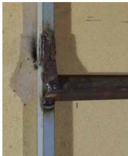
2. Détail de la cornière rajoutée sur la partie centrale supérieure du châssis pour permettre l'accrochage par suspension au mur
