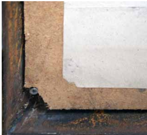
Corrosion à l'intérieur des cornières qui forment le cadre, sur tout le pourtour des panneaux d'aggloméré, et éclat du coin inférieur dextre du support en aggloméré
