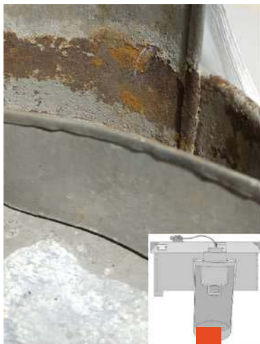
Fig. 84 Détail de la corrosion sur la lampe 1 ©Gabrielle Chailloux
