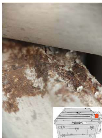
Fig. 88 Détail de la corrosion de la lampe et soulèvement de la couche picturale ©Gabrielle Chailloux
