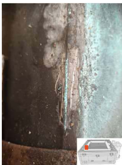
Fig. 87 Détail de l'abrasion sur le chauffage centrale ©Gabrielle Chailloux
