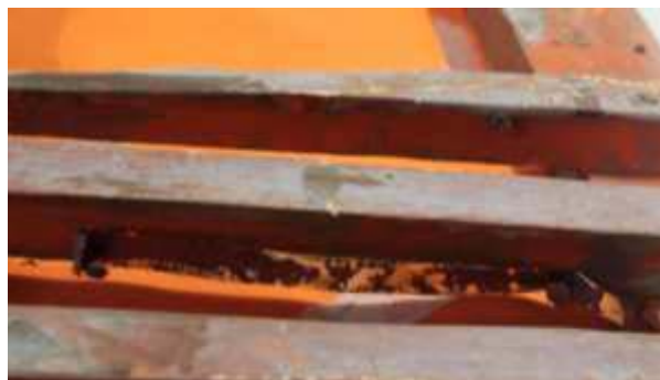
Elément perdu sur l'une des poutrelles horizontales en bois
