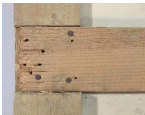
Détail du défibrage du montant de 30(C)
