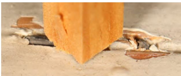
Fig.106 Détail de la lacune de penture sur le socle
