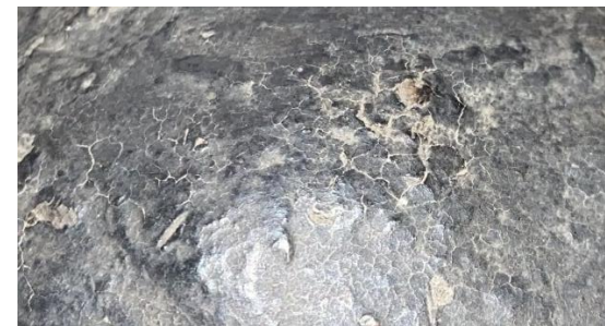
Figure 41 : Micro-craquelures dans la couche de surface
