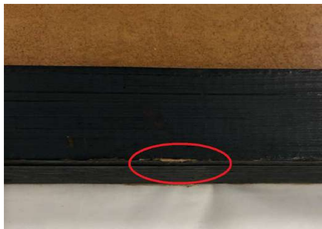
Fig.94. Photographie, détail lacune de la peinture
