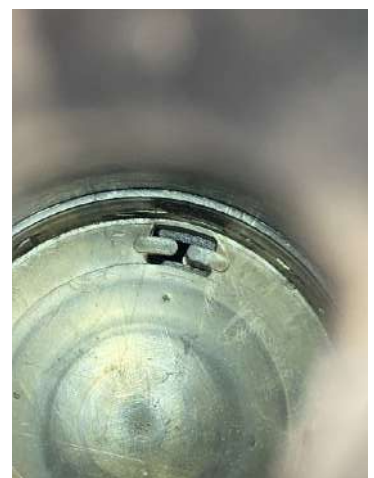
Figure 32 : Détail intérieur de la colonne, disque interne. ©Z.Pacreau.
